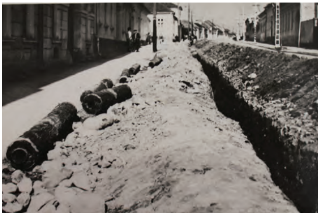
Figura 29. Str. Avram Iancu, conducte de aducțiune a apei, din lemn (fotografie de arhivă) / Avram Iancu Street, wooden water supply pipes (archive photo).
