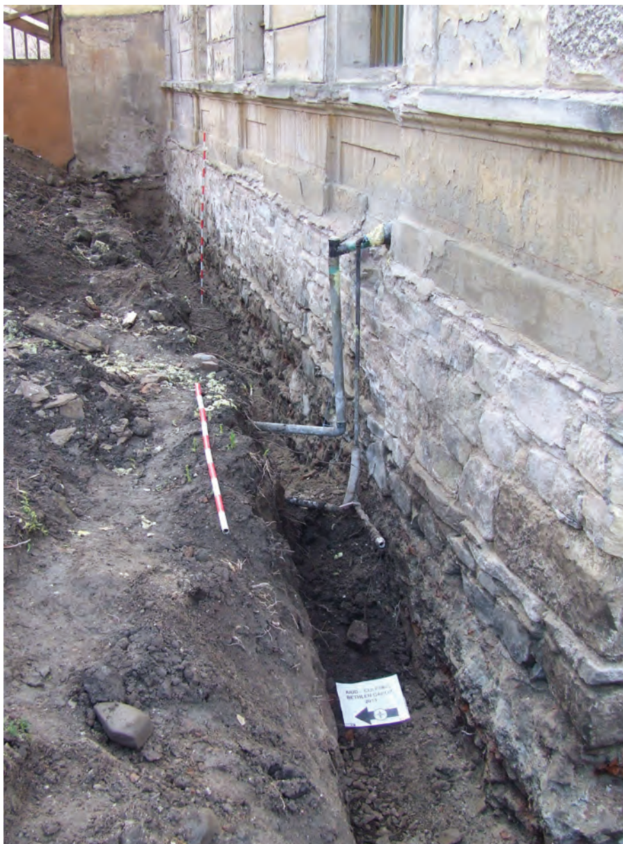
Figura 31. Foto latură nordică corp C1, fundație dezvelită / Photo: northern side of building C1, the uncovered foundation.
